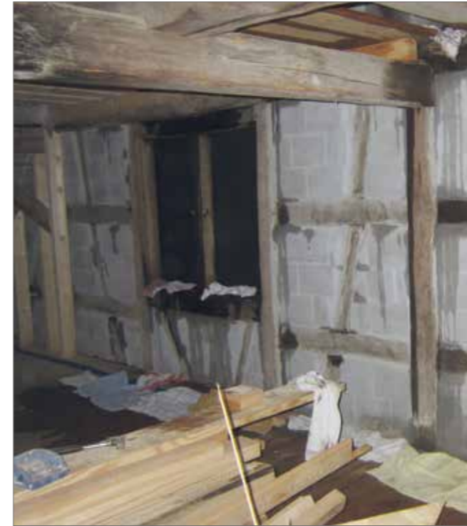
Pluie battante côté intérieur d'un mur à colombages.
