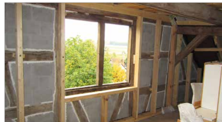
Enduit intérieur sur mur à colombages, amélioré : les joints de raccord entre maçonnerie et poutre ont été soigneusement optimisés, de sorte que la pluie battante ne puisse plus pénétrer si facilement.
