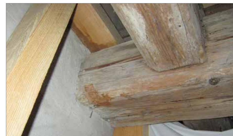
Poutre fissurée : les poutres fissurées peuvent être à l'origine de fuites
