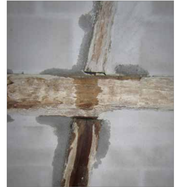
Vue rapprochée : la pluie battante pénètre à l'intérieur de tous les joints
