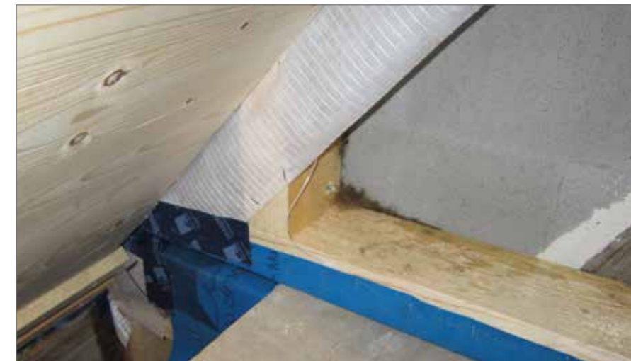
Étanchéité à l'air de bout en bout au niveau du revêtement du plafond
