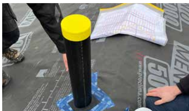
... et de tuyaux de ventilation (ROFLEX).
